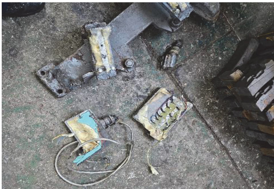
Fig. 17. Legătura de gardă, cablu de alimentare smuls al inductorului
