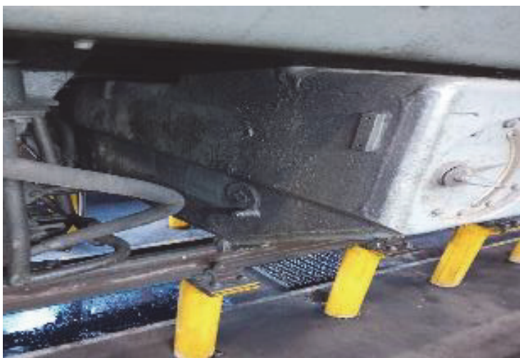
Fig. 8. 2 piulițe de fixare a rezervorului colectare reziduuri (una la partea interioară a locomotivei – poziția de jos și una la partea exterioară a locomotivei – poziția de sus) cu ruptură veche din sudură
